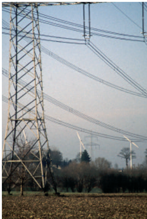
Dezember 2012: Freileitung und Windräder bei Buir.
